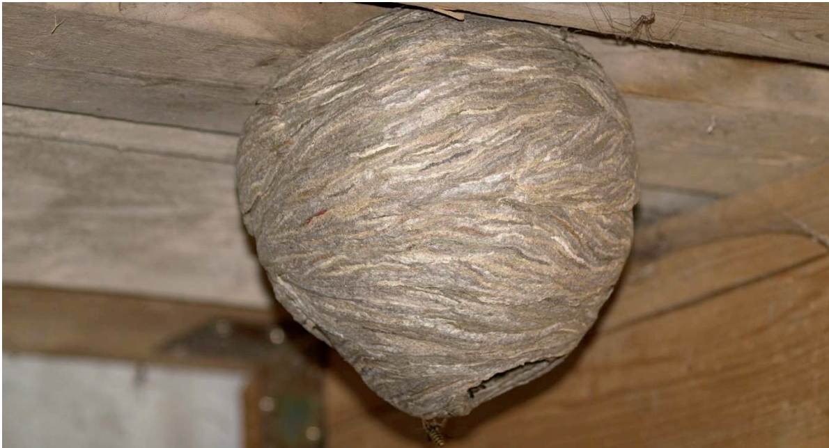
Abb. 4: Wespennest im Gebäude (Quelle: Bild von ariesa66 auf Pixabay)
