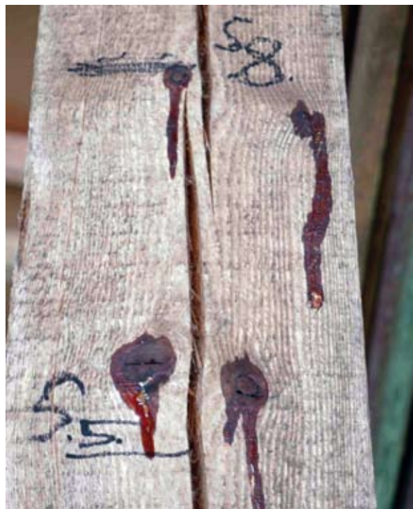
Abb. 3: Harzaustritt an einer Kiefernstütze nach einer Bekämpfungsmaßnahme
