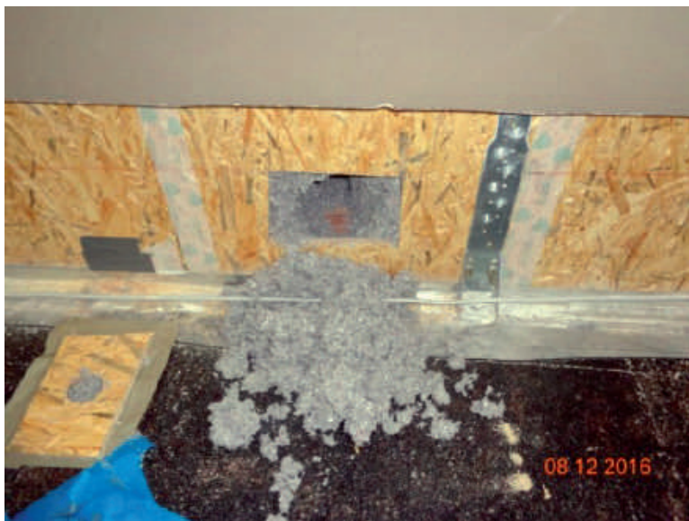
Abb. 3: Zellulose als Außenwanddämmung (Quelle: Blei-Institut)
