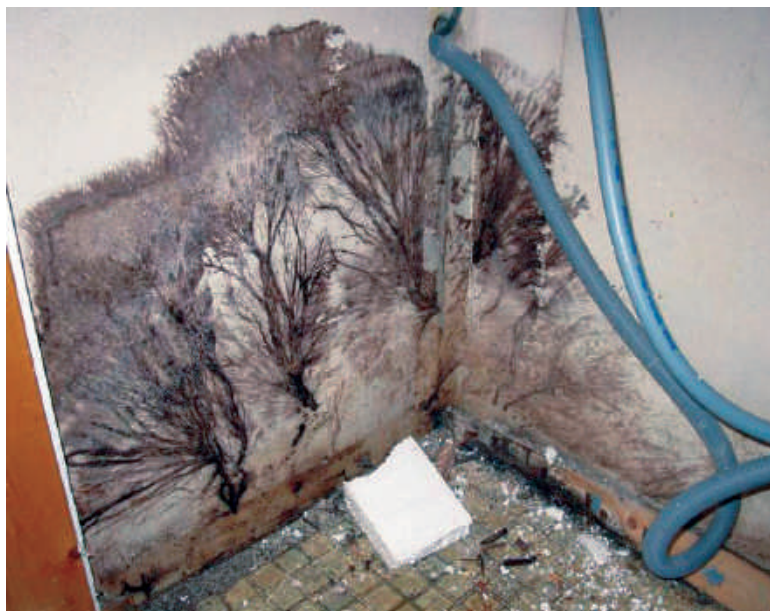
Abb. 6: Braune Kellerschwamm ( Coniophora puteana ) auf Holzständerkonstruktion (Quelle: Blei-Institut)
