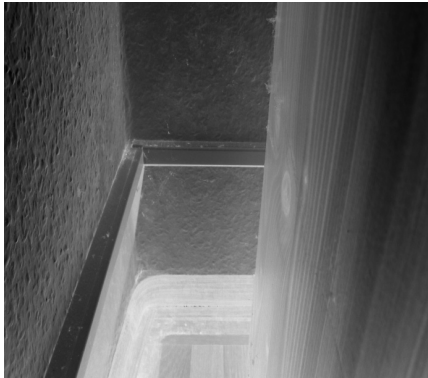
Bild 4.2: Schimmelbefall hinter Schrank
